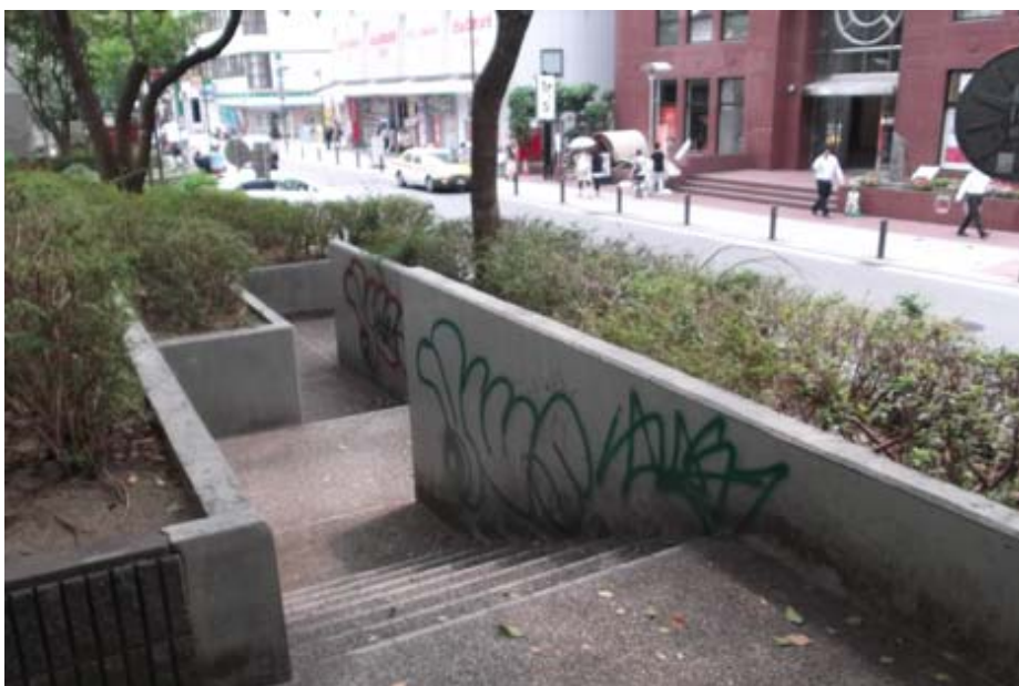
警固公園通り側通路の壁の落書き
