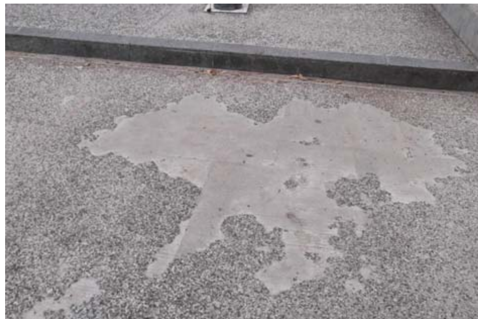
ピストバイクによる舗装面の破損
